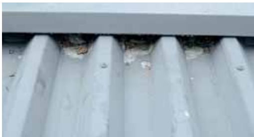
Katon koloihin kertyy herkästi orgaanisia epäpuhtauksia, jotka sitovat itseensä kosteutta. Näissä kohdin pinnoite irtaoo herkästi ja ruostuminen pääsee alulle.
